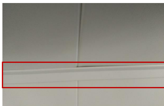
Figuur 5: Locaties geobserveerde lekkages (1)
